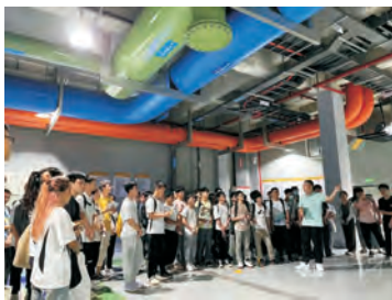
学生在制冷机房认识实习
